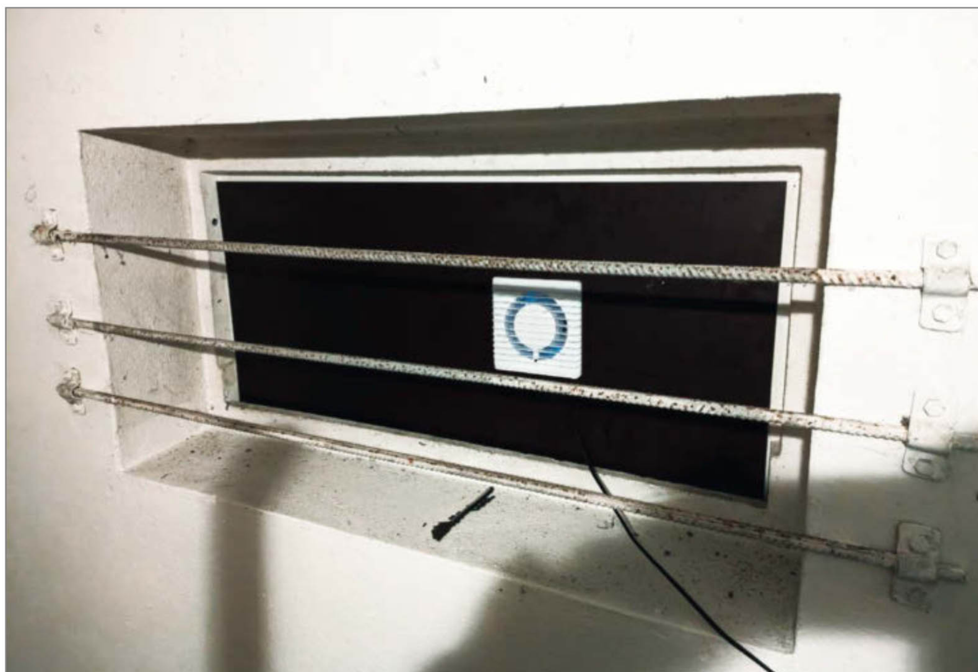
Bild 11: Die Glasscheibe im Fenster musste einer Siebdruckplatte weichen.
