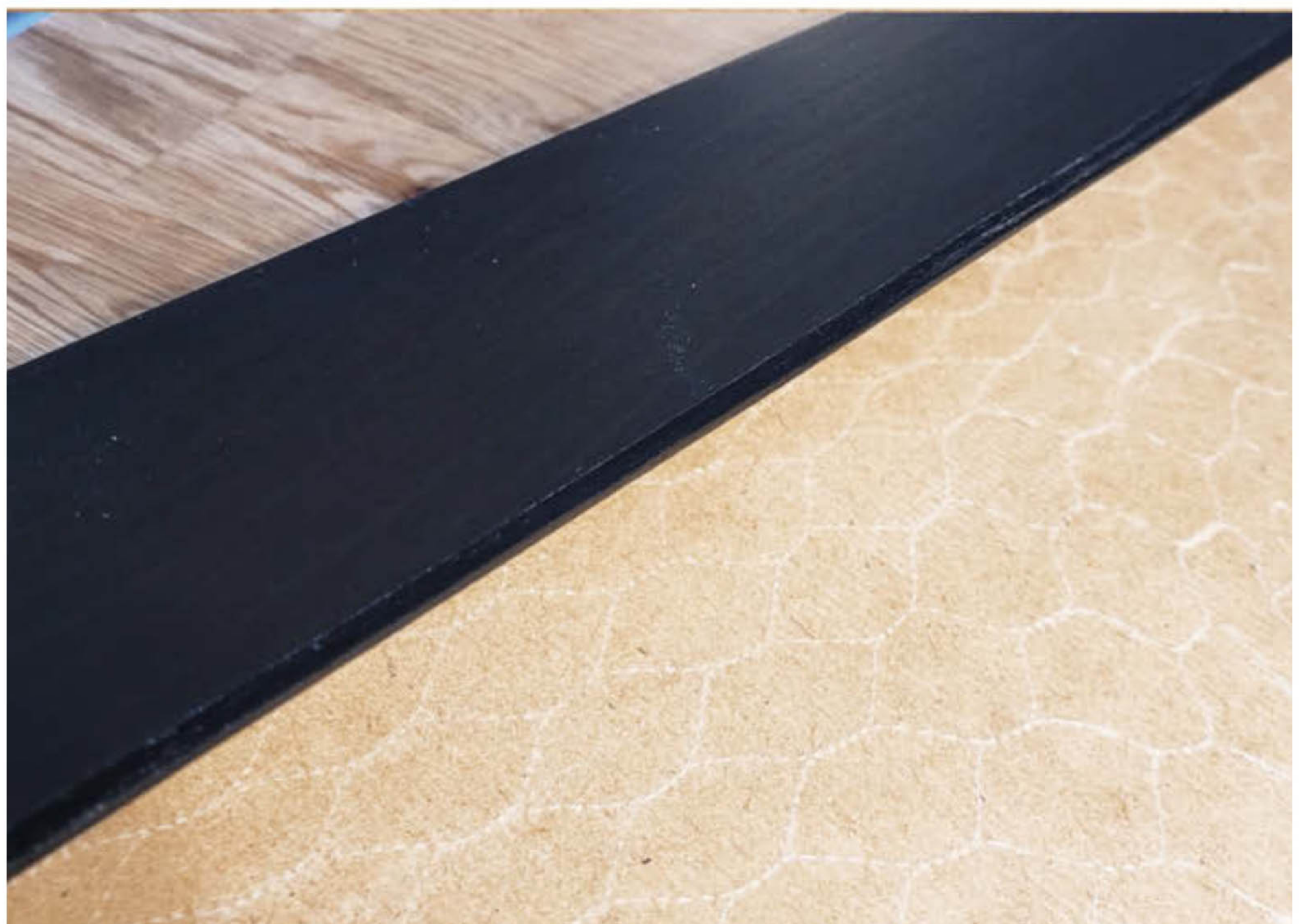
Abbildung 9: Beschädigungen an der Schnittkante und die Reparatur mit d-c-fix-Klebefolie.
