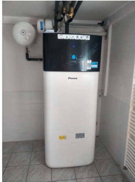
Das Innengerät einer Luft-Wasser-Wärmepumpe kann recht groß ausfallen, wenn es wie hier den Pufferspeicher integriert.
