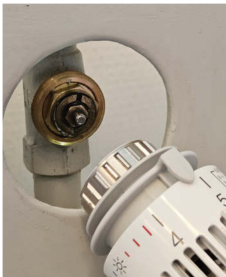
Die Ventil-Voreinstellung befindet sich unter dem Thermostatkopf.
